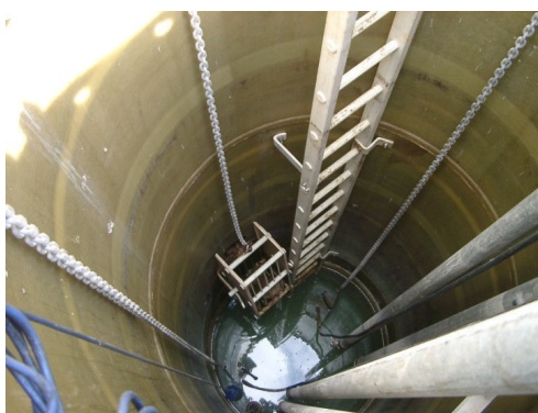
La fosse du poste de refoulement 147 à Arnières-sur-Iton
