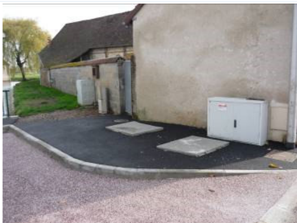
Vue sur le poste de refoulement qui transfère les eaux usées vers le réseau de l'ex-GEA.
