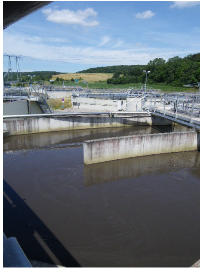
Vue de la zone endogène du bassin d'aération du CTEU
